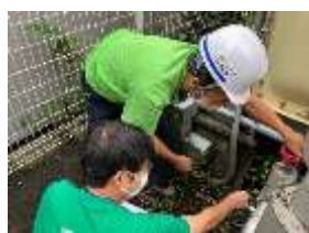
受水槽からの給水
